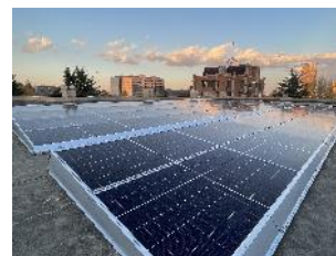
各キャンパス太陽光発電設備設置
